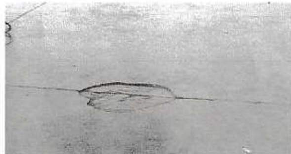
Foto 2: Sustrucción de piso cerámico aula 2. El piso es torta y por los años que tiene de uso está quebrado haciendo muy difícil poder darle mantenimiento
