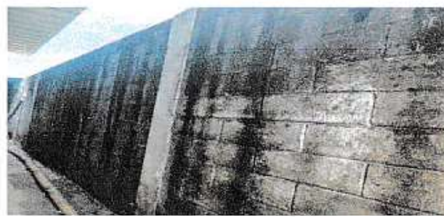
Foto 4: Pintura en muros interiores. Los muros se encuentran húmedos, necesitan tratamiento. Para mejorar el ambiente visual.
