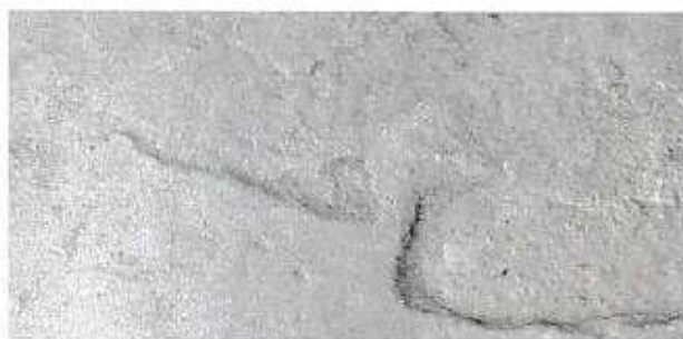
Foto 3: Sustrucción de piso cerámico aula 3. El piso es torta de cemento y se encuentra en mal estado por los años que tiene de uso dificultando su mantenimiento.
