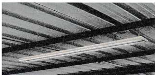
Foto 5: Sustrucción de lámpara aula 3.
